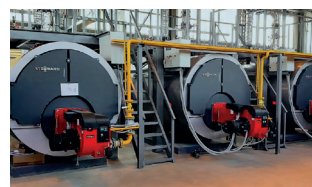
Котельная жилого комплекса с Vitomax HW
