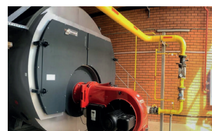
Котельная предприятия по производству сыров с Vitomax HS
